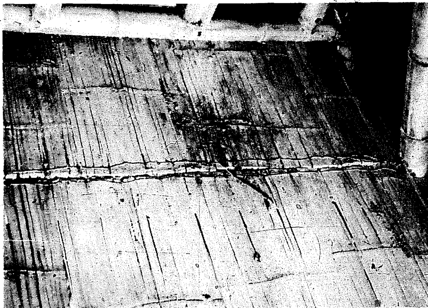
Figura 2-20. Piso de esterilla del entrepiso. Cuando se empleen esterillas cortas, su unión debe hacerse en lo posible en el área de la tolva y no en la zona de tráfico.
