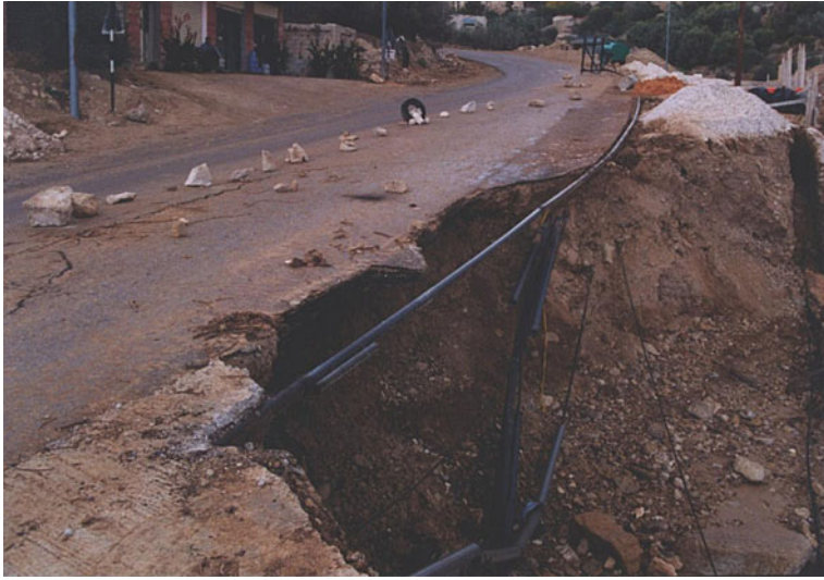
Fig. 5.6 Flash flood damage in Wadi Musa
