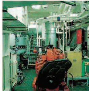
la salle des moteurs engine room
